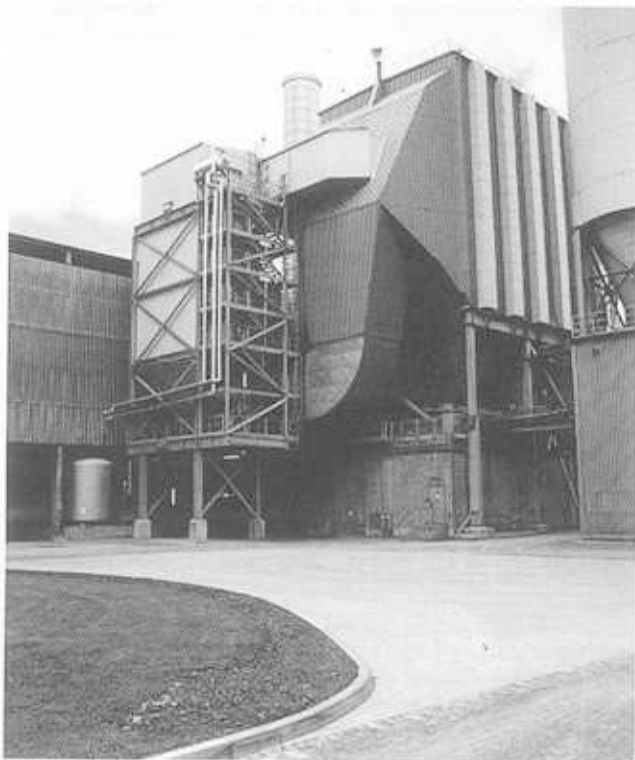
BILD 4: Abhitzekeesselanlage mit Anschluss an das Heißelektrofilter FIGURE 4: Waste heat boiler plant with connection to hot electrostatic precipitator
